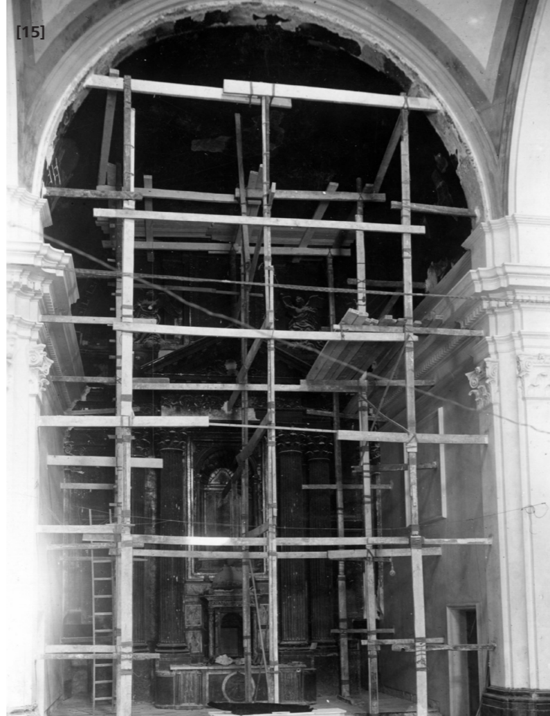
[15] Vista del andamio instalado para el acceso a las pinturas quemadas del presbiterio de la bóveda de la iglesia del Santo Ángel de la Vall d'Uixó, en Castellón.
